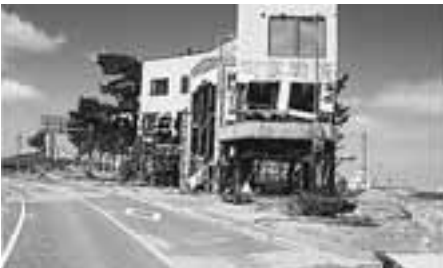
海水浴場に近いこの食堂は鉄筋だったので形だけ残った。海水に洗われた道路は部分的に通れる所もあった。
